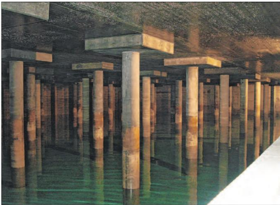
Blick in einen der Hochbehälter in Leonberg. Etwa 24.000 Liter Wasser passen in die zwölf Speicher. Foto: Stadtwerke Leonberg
